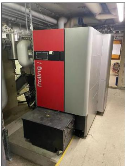
Chaudière à bois (copeaux)
