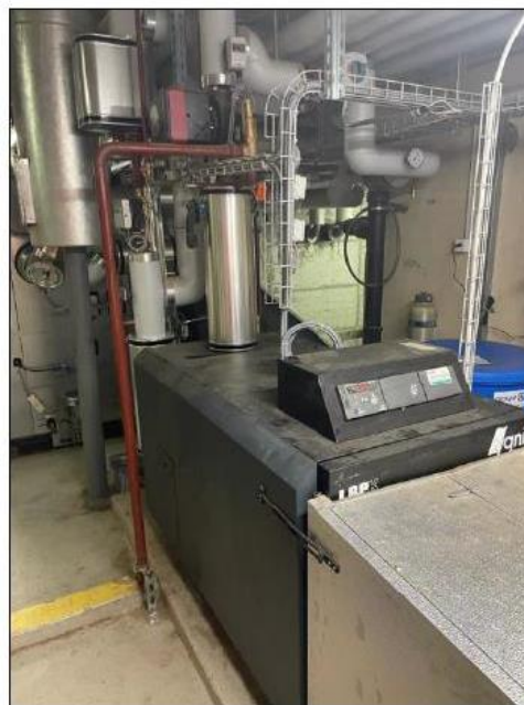
Chaudière à mazout d'appoint
