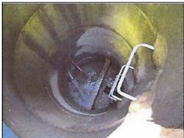
Captage non-conforme aux exigences SSIGE (Accès direct sur le plan d'eau)
